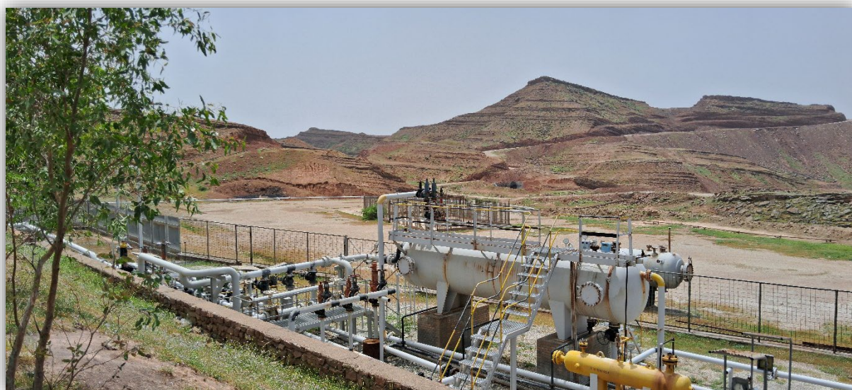
شکل ۸- نمای کلی واحد بهره‌برداری کلاستر کبود
